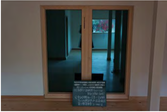
写真6.5.3.1-39 表面変色の確認（実証試験体3） 3-WW-2
