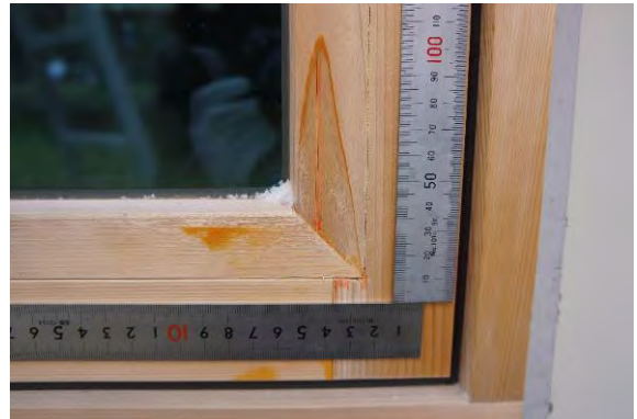
写真6.5.3.1-30 3-WW-4 (実証試験体3) 外部障子割れ
