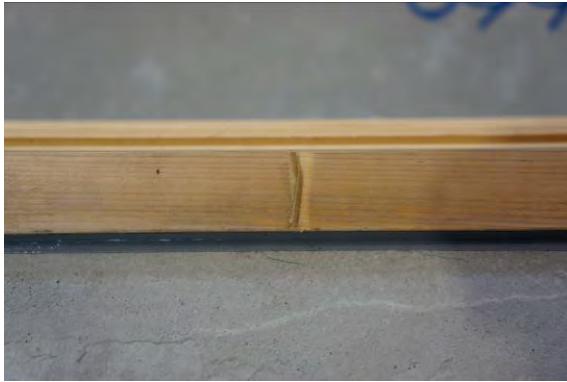
写真6.5.3.1-33 表面変色の確認（実証試験体2） 枠表面の削り取り
