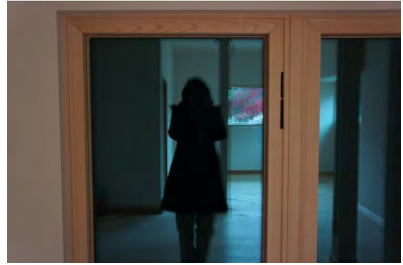
写真6.5.3.1-40 表面変色の確認（実証試験体3） 3-WW-2
