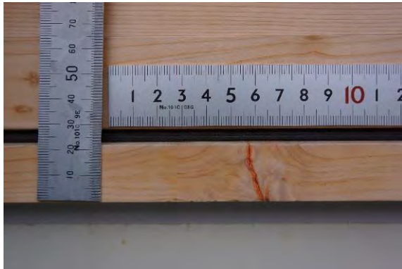
写真6.5.3.1-29 3-WW-4 (実証試験体3) 外部枠割れ
