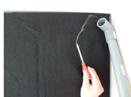
写真6.5.1-8 試験体1 換気システム稼働 排気確認
