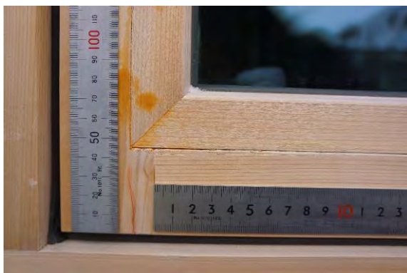
写真6.5.3.1-31 3-WW-4 (実証試験体3) 外部障子割れ
