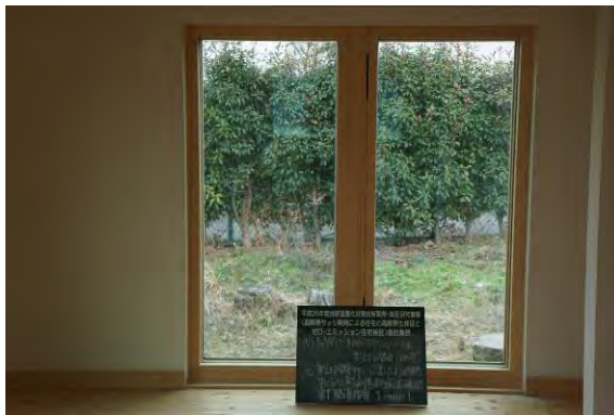
写真6.5.3.1-35 表面変色の確認（実証試験体1） 1-WW-1
